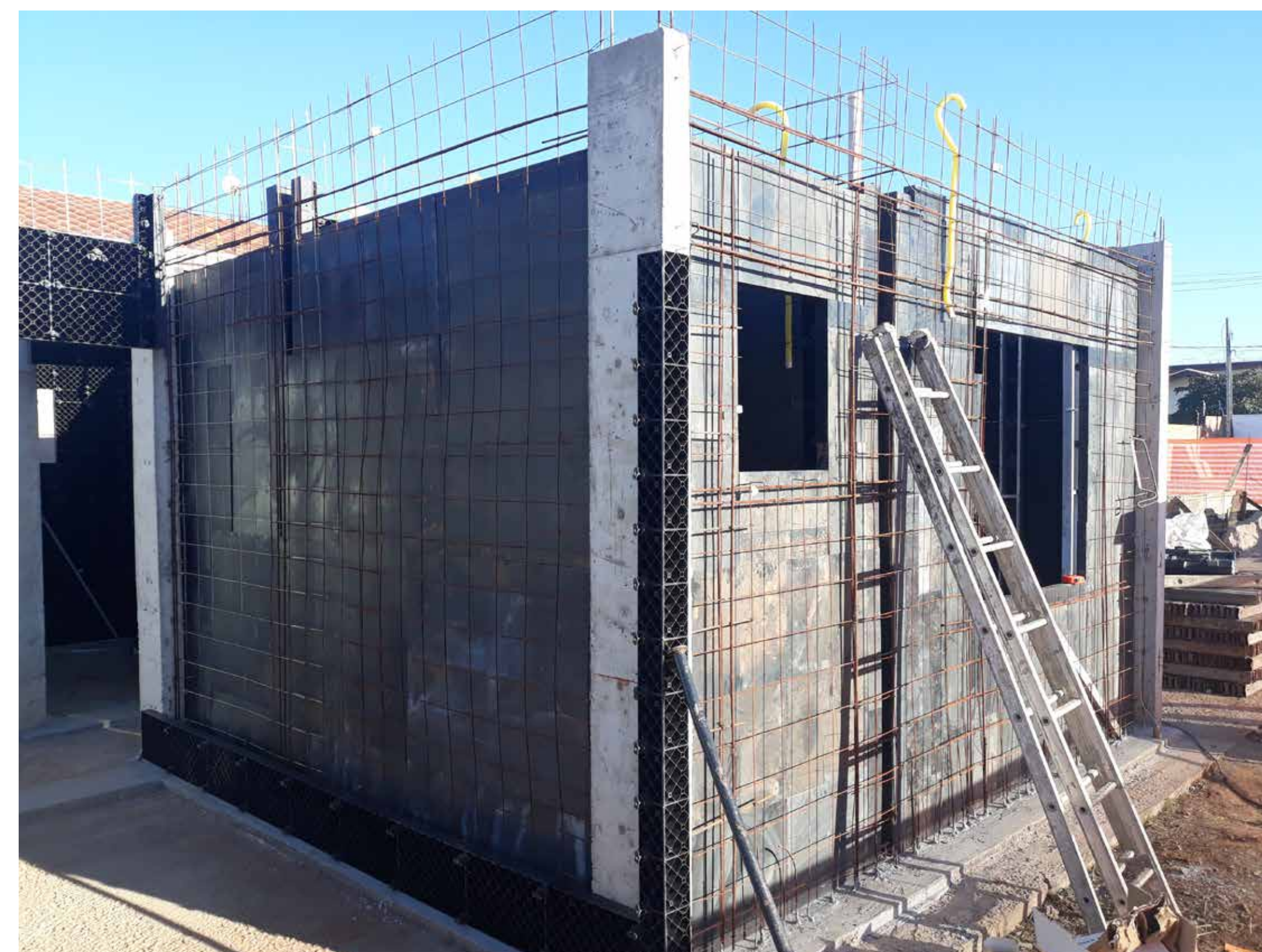
À esquerda, gabarito da casa protótipo pronto para receber o concreto sustentável desenvolvido pela Jetra Construtora em parceria com o LCC do IAU e apoio da Finep.
