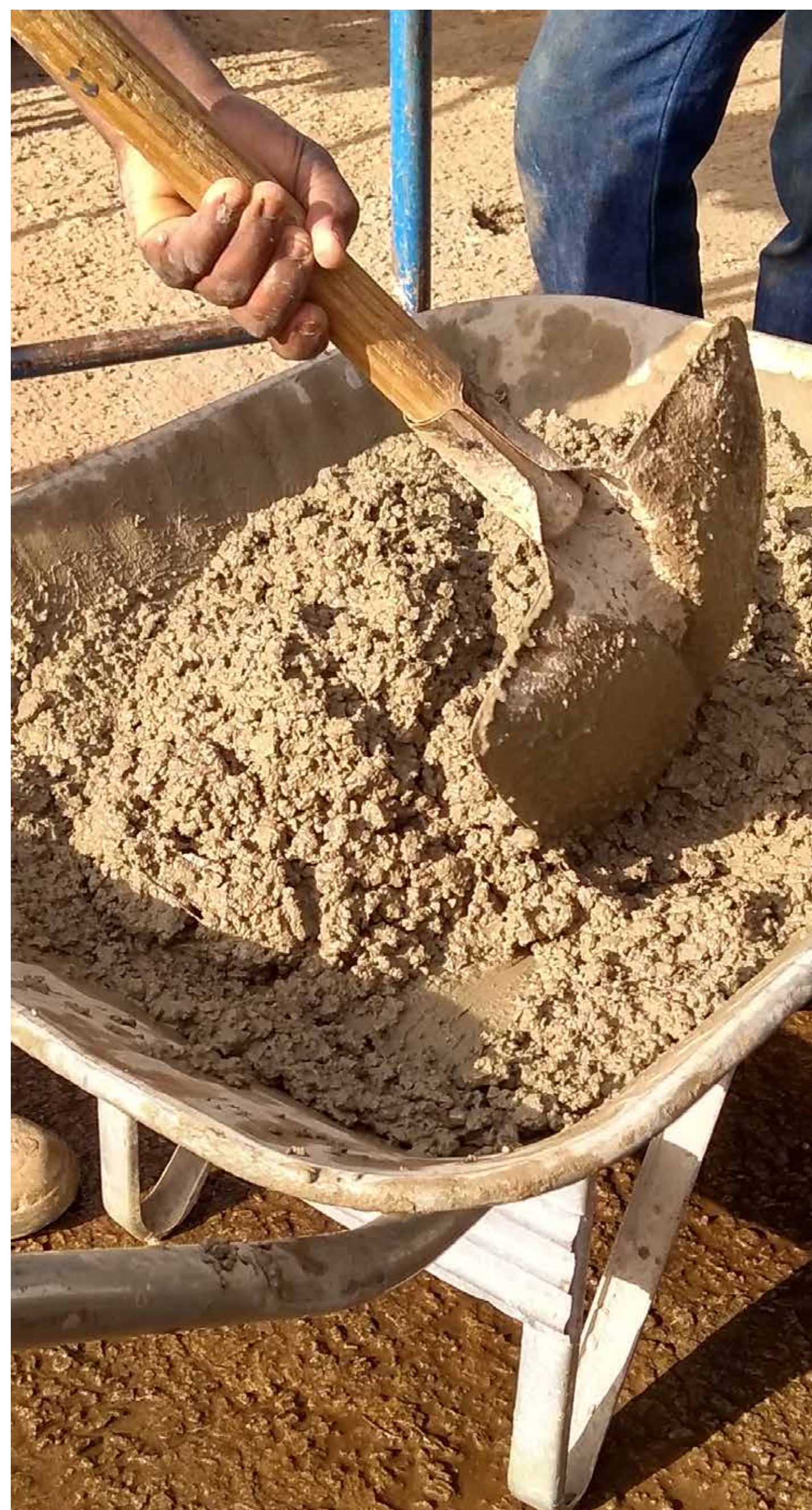
Concreto produzido com agregados reciclados em canteiro de obras da casa protótipo construída pela Jetra Construtora no interior de São Paulo.
