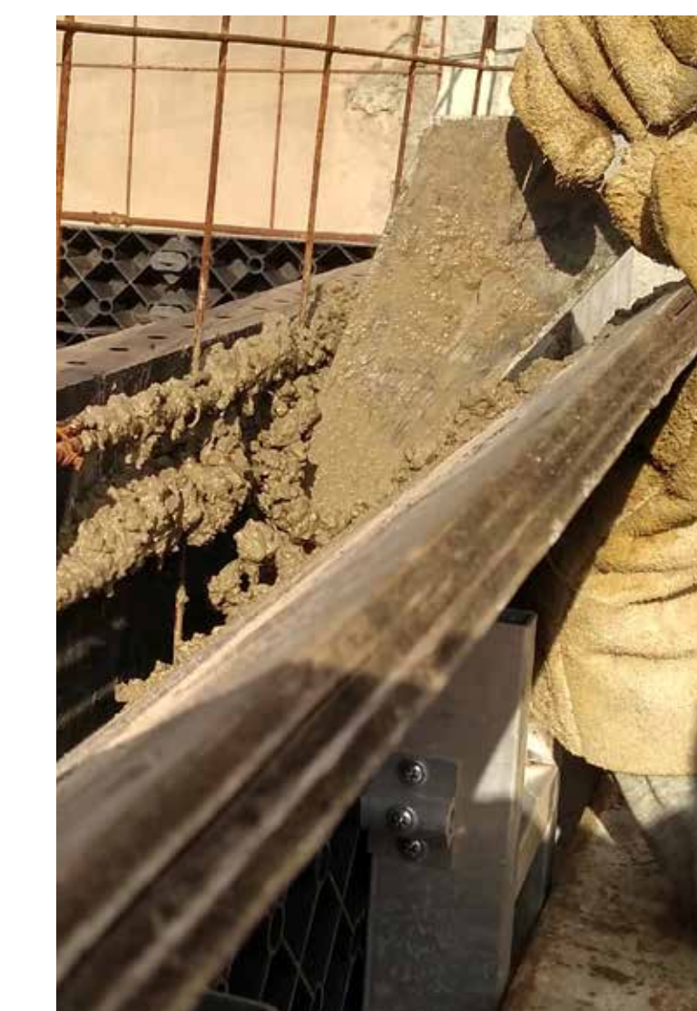
Abaixo, aplicação do concreto com agregados reciclados em fôrma na obra da casa protótipo conduzida pela Jetra Construtora, no interior de São Paulo.
